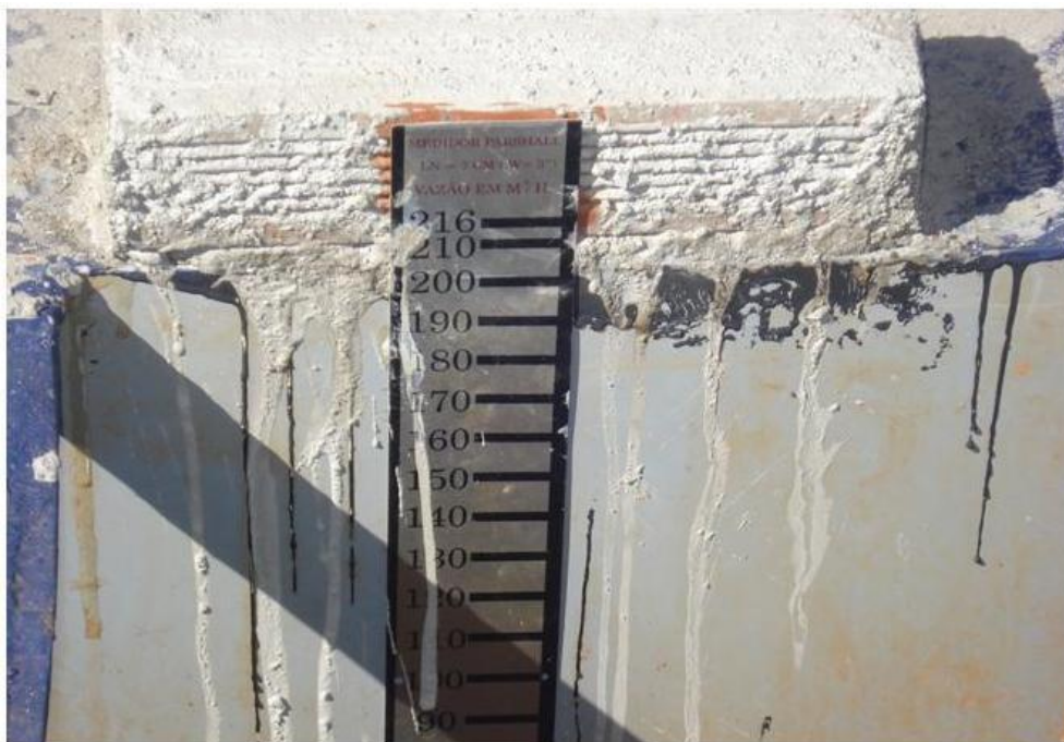
Figura 12: Medidor da calha parshall.
