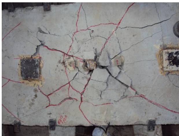
Figura 14. Ruptura por fendilhamento.
